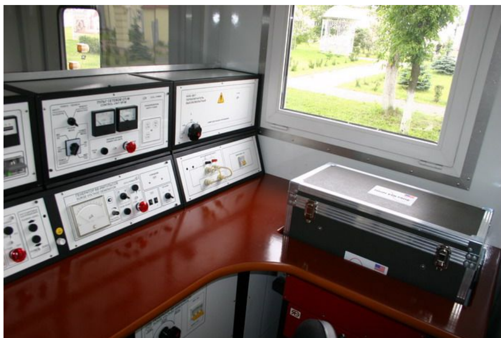
Вид на отсек оператора лаборатории ЛВИ НVT -2V на базе ГАЗ-331043
